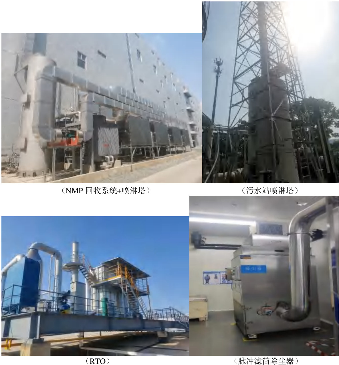
图 4-5 废气处理设施图
