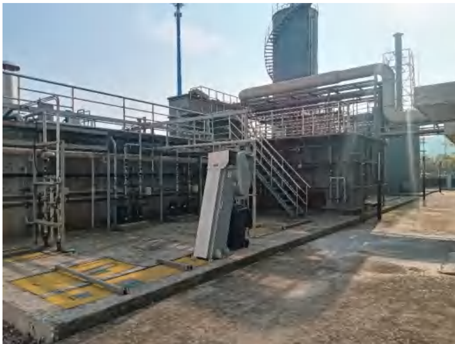
图 4-2 自建污水处理站
