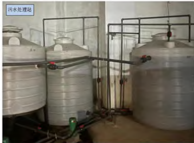
图 4-2 医疗废水处理站现场照片
