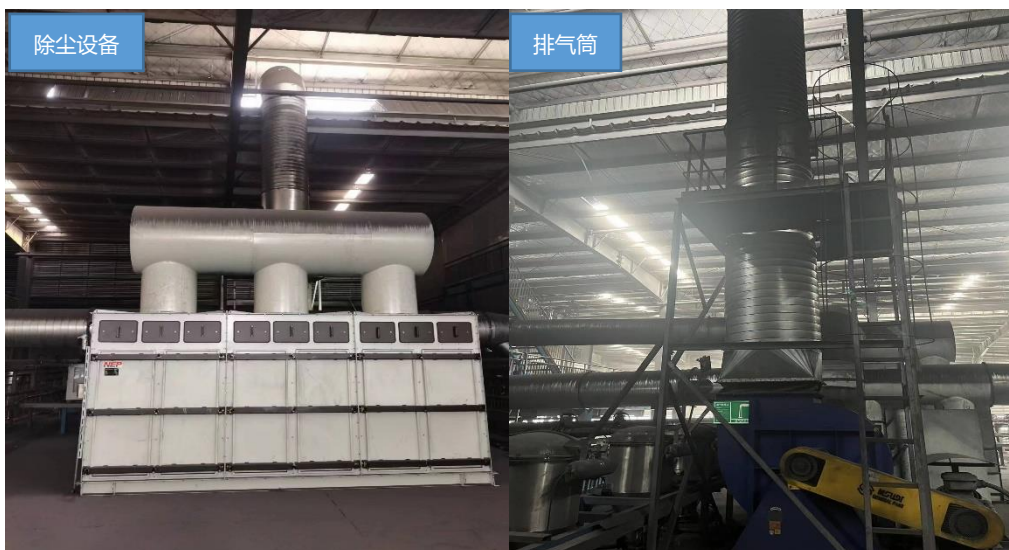
图 3-1 废气治理设施现场照片
